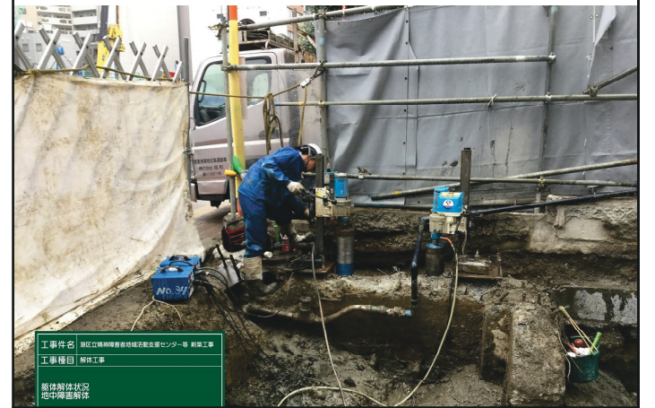
②-2 既存擁壁下の障害物
