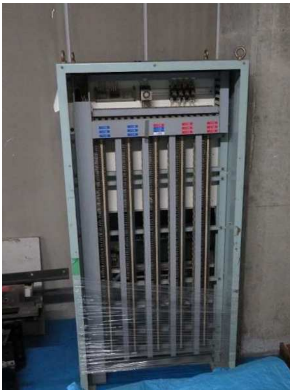
▲写真6 4・5号機共通制御盤
