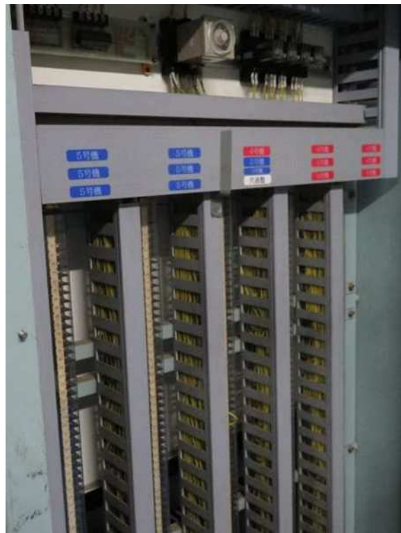
▲写真7 4・5号機共通制御盤 (拡大)
