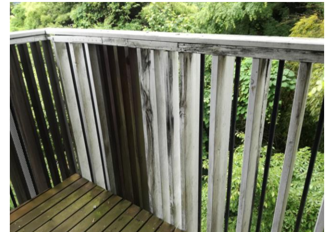
ルーバーとデッキの劣化
