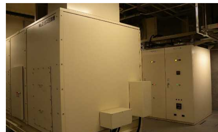
非常用発電機
