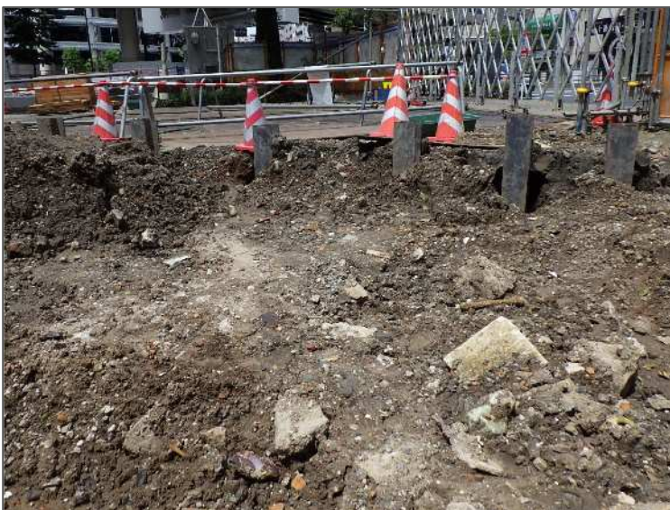
がれき混じり土砂
