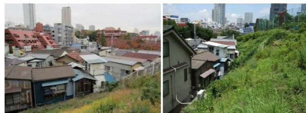
緩傾斜化や安全な擁壁に整備することが求められている、急傾斜地崩壊危険箇所として公表されている斜面地に面して建つ住宅
