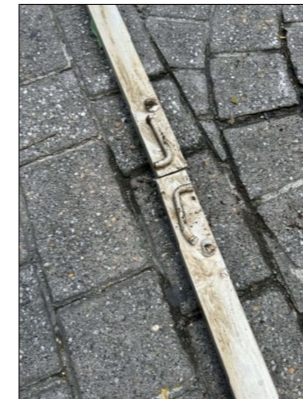
受枠底部の金具欠損状況
