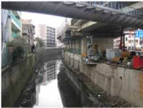
古川の護岸整備状況（古川橋上流側） 出典：東京都 HP「古川整備工事（その9）」
