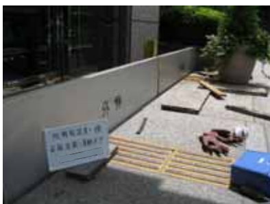
止水板（港区役所）
