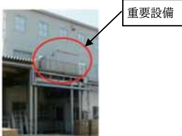
重要設備の高所配置
