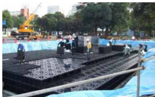
区立芝公園の地下に設置された雨水貯水槽
