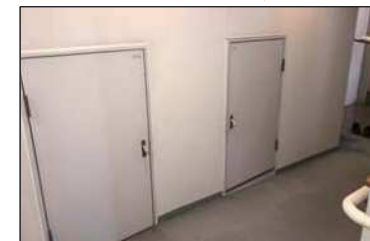
【Fig.8】 集会室前ホール 電気配線シャフト パイプスペース扉
