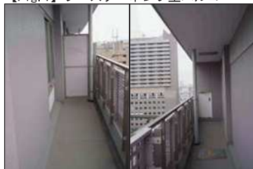
【Fig.1】ブースターポンプ室バルコニー
