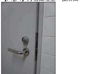
【Fig.4】 汚物処理室~便所間
