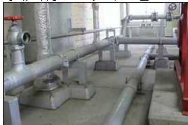
【Fig.2(2)】ブースターポンプ室
