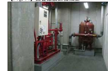
【Fig. 14】 図書館設備機械室
