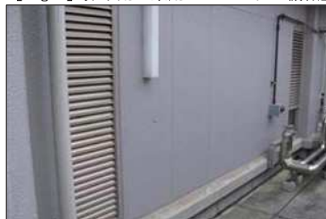
AG(アルミガラリ)あり、設備架台に腐食 あり。
