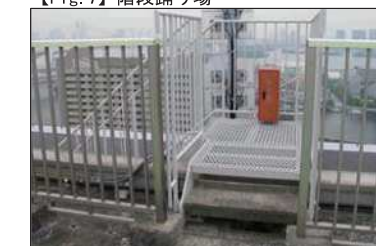
消火器BOXに腐食と文字欠けあり。
