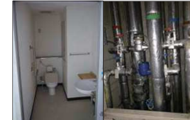
【Fig. 12】夫婦居室便所内パイプスペース
