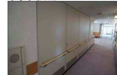
【Fig. 9】電気配線シャフト
