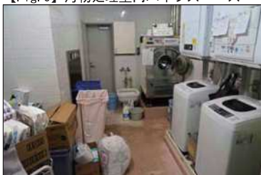
【Fig.5】 汚物処理室内パイプスペース
