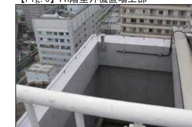
梁壁面に汚れあり。
