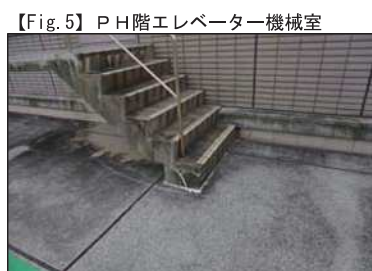
【Fig.5】 PH階エレベーター機械室
