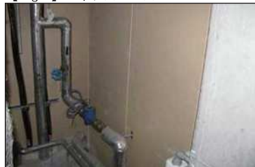
【Fig.4】パイプスペース
