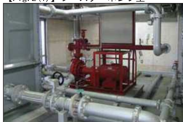
【Fig.2(1)】ブースターポンプ室
