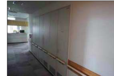
【Fig.13】電気配線シャフト
