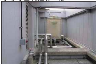
機械置場や機械基礎の防水処理や塗装仕上 に劣化、汚れあり。
