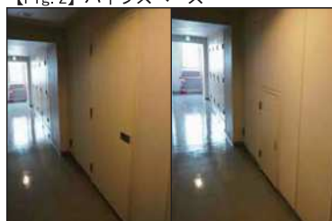
【Fig. 2】パイプスペース
