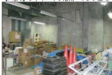
【Fig. 6】 シティハイツ港南 ポンプ室-2
