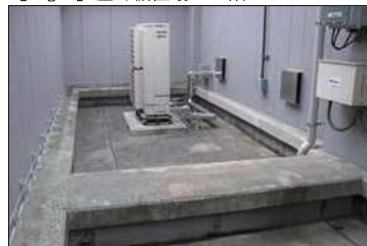
機械置場や機械基礎の防水処理や塗装仕上 に劣化、汚れあり。
