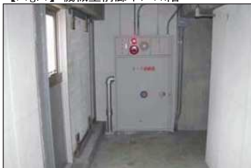
消火栓格納箱は塗装欠けあり。 外壁ALC(軽量気泡コンクリート)壁板上下 取付金物は腐食あり。
