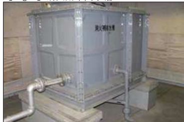
【Fig.3】消火用中間水槽
