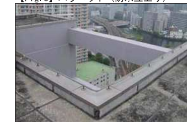
防水立上りの角部、欠けあり。
