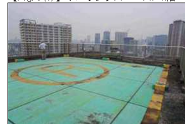
屋上サインの向きが反転済、方向表示あり。
