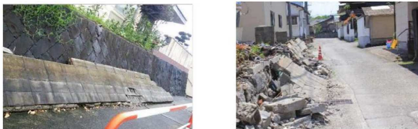
ブロック塀の被害（出典：熊本地震デジタルアーカイブ）
