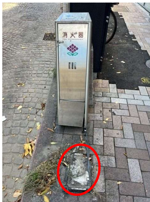
消火器格納箱の土台の損傷状況
