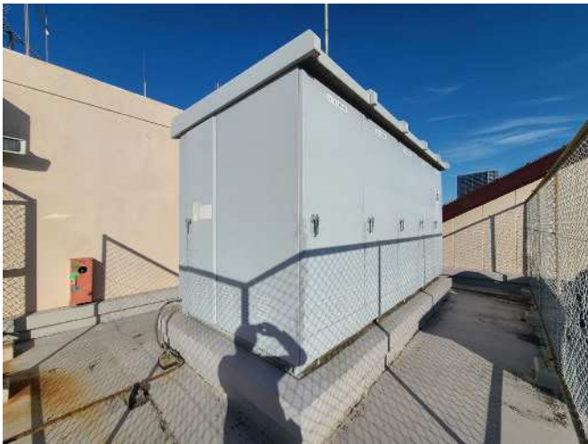
屋上 受変電設備
