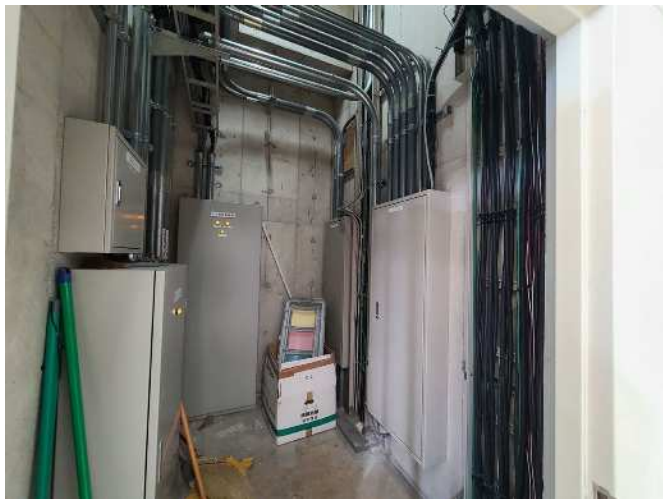
EPS内 幹線・動力盤
