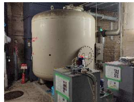
プールろ過装置
