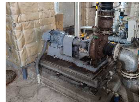
ろ過ポンプユニット
