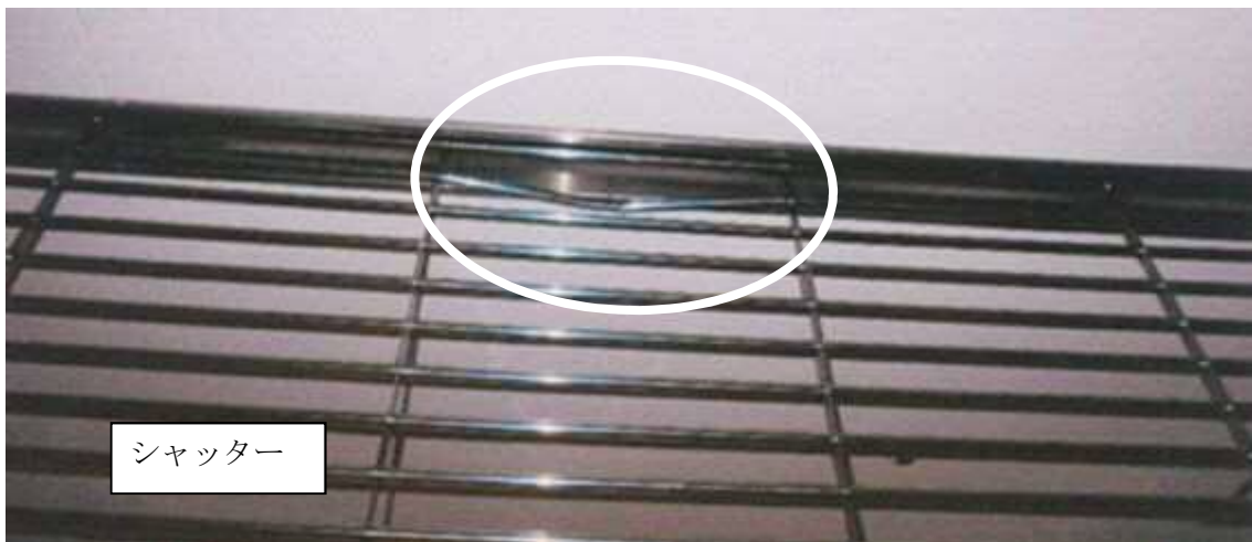
相手方建物：シャッターの損傷状況（丸枠内が損傷部分）
